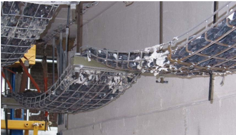
Bild 3: Verformte Gitterrinne nach der Brandprüfung
